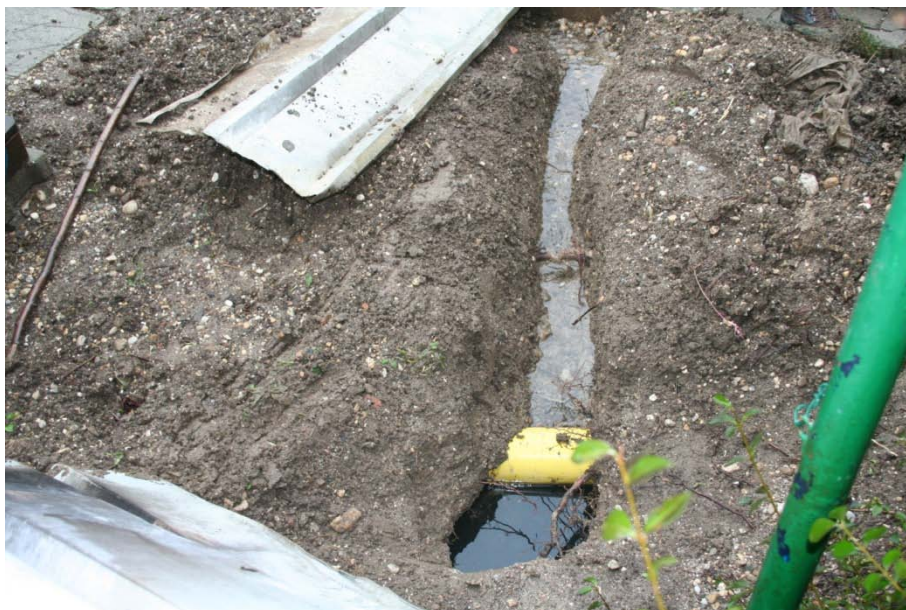
Slika 19: Zemeljski udor - na površini
