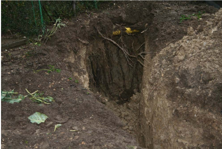
Slika 20: Jama zemeljskega udara po odkopu
